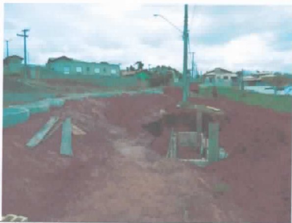
FOTO 61. Vista geral de área afetada por movimentações de aterro/solo que afetaram parte do sistema viário.
