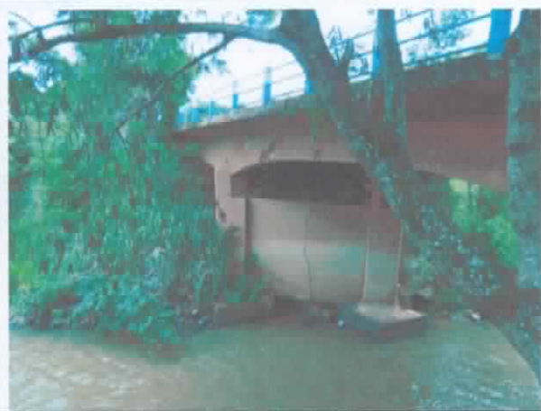
FOTO 28. Registro de ponte sobre o ribeirão dos Carrapatos. Notar que as estruturas apresentam patologias como trincas e pequenos deslocamentos.
