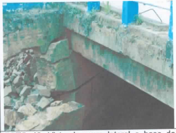
FOTO 46. Vista de muro lateral e base do taluleiro da travessia afetado por movimentações do terreno.
