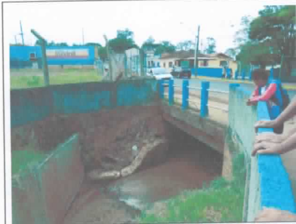
FOTO 45. Vista de travessia de drenagem e do ribeirão Lageadinho, nas proximidades da Via Cap. Cesário. Notar dimensões do canal e trecho afetado por movimentações do terreno (margem esquerda).
