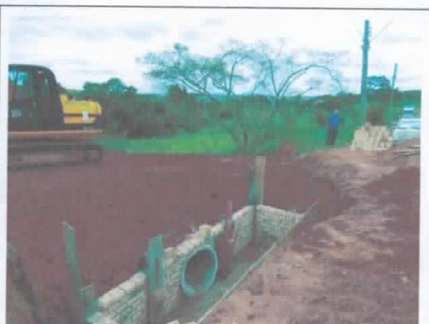
FOTO 64. Vista das obras de reconstrução dos sistemas, com ampliação e reforço das estruturas.
