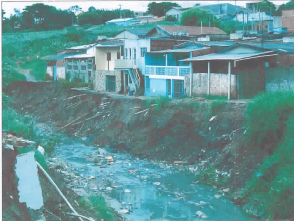
Figura 23 – Situação de risco associada a erosão e solapamento dos taludes marginais, com ocupação ribeirinha (Ministério das Cidades, Instituto de Pesquisas Tecnológicas do Estado de São Paulo – IPT, 2007).
