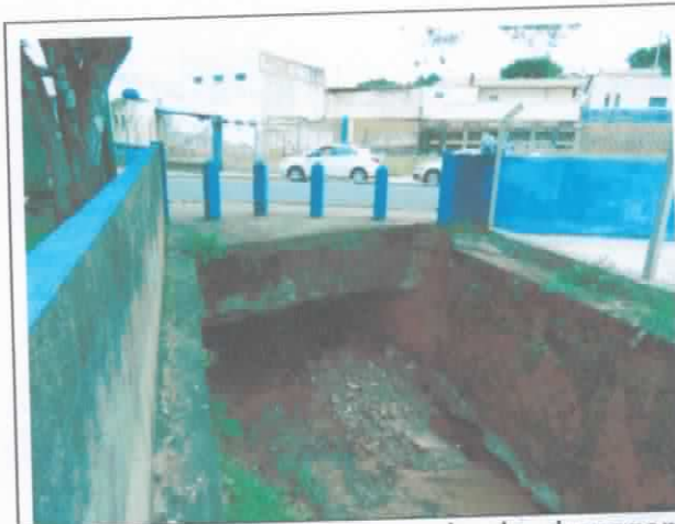
FOTO 53. Vista de travessia de drenagem com destaque para a dimensão do vão e dos materiais depositados no leito. Notar dimensões do canal.
