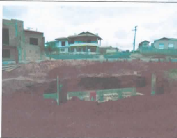
FOTO 63. Vista geral de área afetada por deslizamento pontual. As movimentações ocorreram em função de rupturas do sistema de coleta e condução das águas pluviais. Notar distância das moradias e sistema viário pavimentado.
