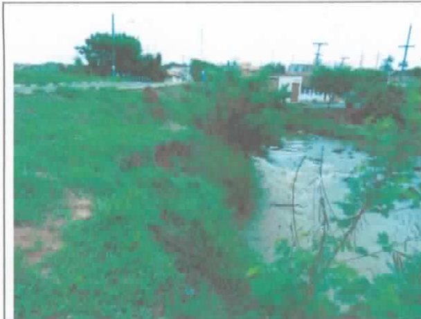
FOTO 21. Vista geral, de jusante para montante, do ribeirão dos Carrapatos. Notar dimensões da margem e pequenas rupturas dos taludes marginais.
