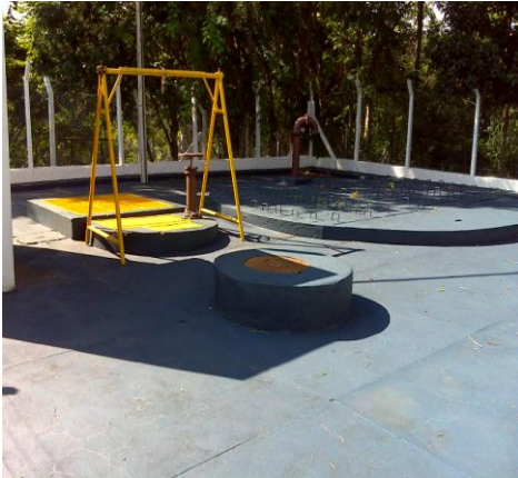
FOTO 4.14– ESTAÇÃO ELEVATÓRIA 01, JARDIM PLANALTO.
