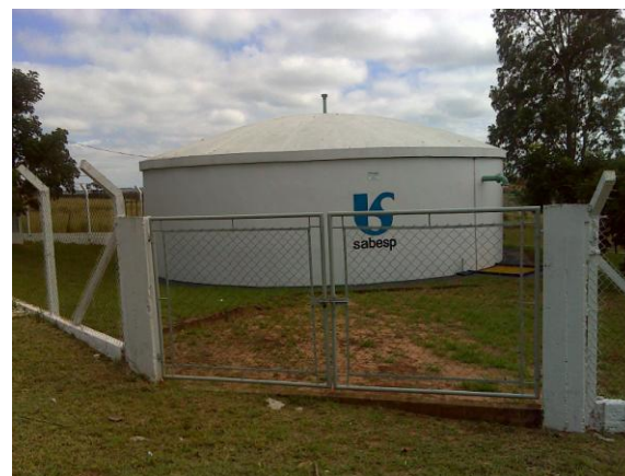
FOTO 4.10 – RESERVATÓRIO DE 500 M 3 , JARDIM MONTE ALTO, ITAÍ.
