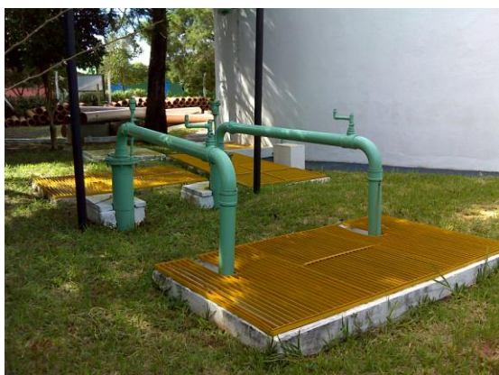
FOTO 4.11 – BOOSTER JARDIM NOVO HORIZONTE.
