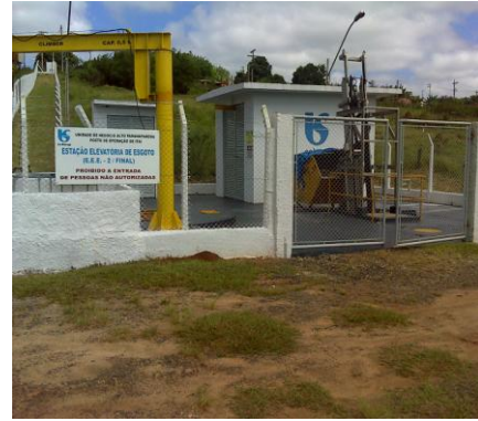
FOTO 4.15– ESTAÇÃO ELEVATÓRIA DE ESGOTO FINAL.
