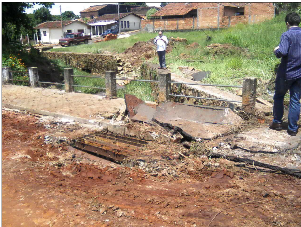
Foto 22.- Travessia danificada na R: Salustiano Soares
