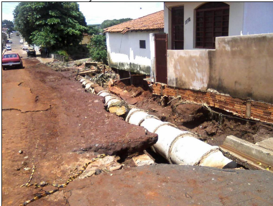
Foto 23.- Pavimentação destruída na R:
