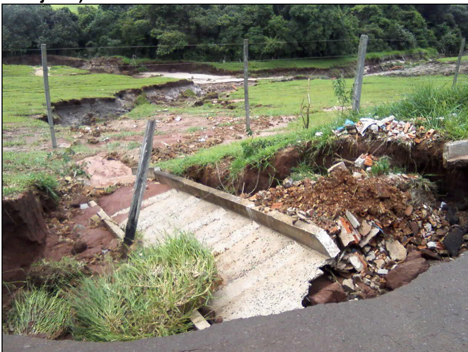
Foto 21.- Danos à pavimentação e início de processo erosivo (Jd. Marajoara)
