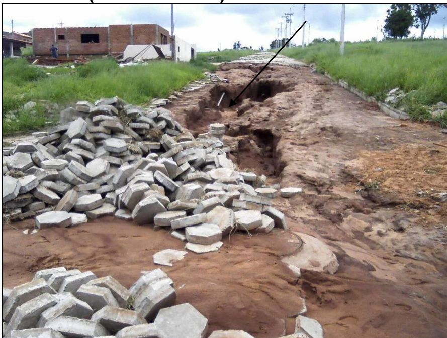
Foto 16.- Pavimentação de lajotas totalmente devastada na R:Sebastião de Oliveira (Jd. Colina Verde)
