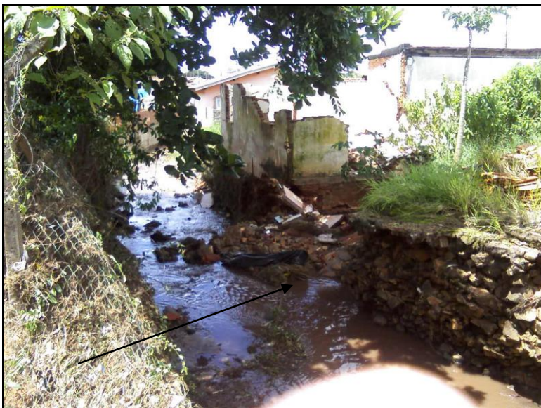
Foto 24, 25 e 26.- Taludes do trecho urbano canalizado do Córrego Lageado danificados
