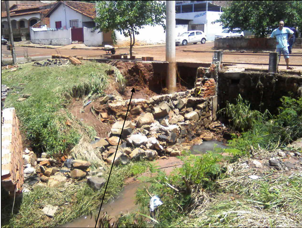
Fotos 27 e 28.- Encostas de travessias comprometidas (Córr. Lageado)
