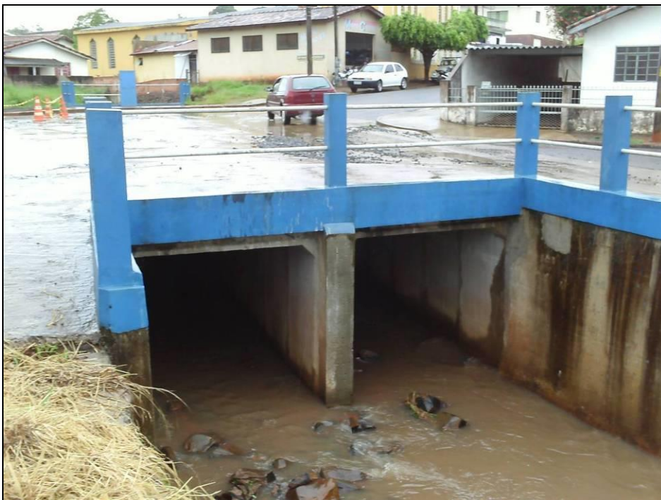
Foto 10.- Travessia da R: Aristides Pires (Córr. Lageado) – duas aduelas de concreto de 1m 2 cada
