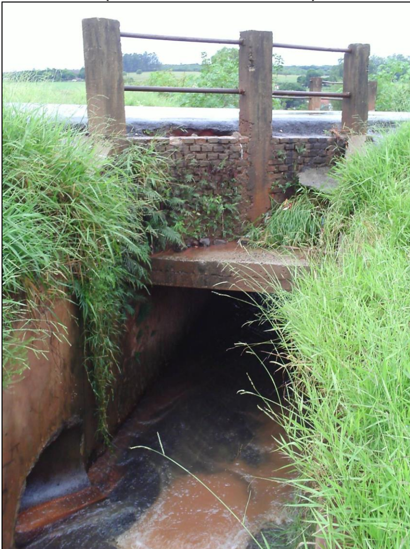
Fotos 14 e 15.- Travessia e vista do canal sobre o córrego sem nome no Jd. Eldorado (aduela de concreto de 1m 2 )
